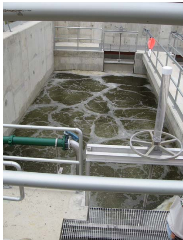
ITT Sanitaire Membrane Diffuser Basin
