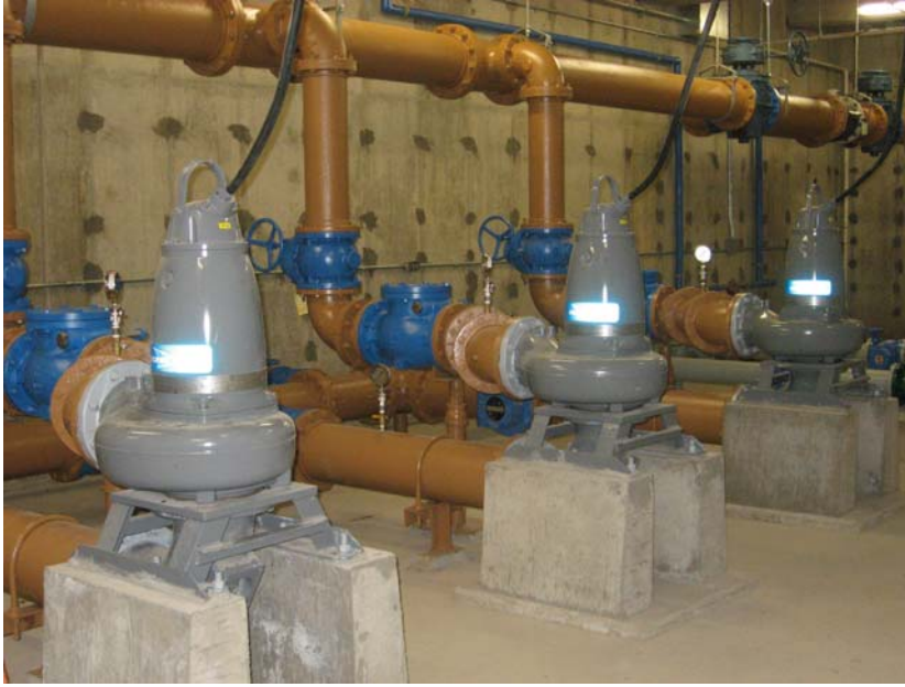
ITT Flygt NT-3153 RAS Sludge Pump Station
